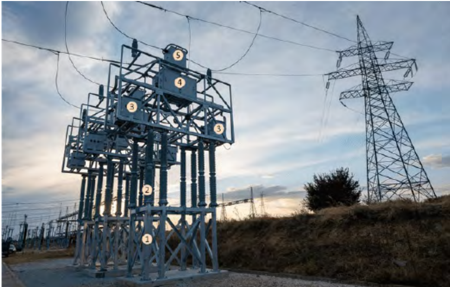
Εικόνα 25: Εγκατεστημένο σύστημα M-SSSC στον Υ/Σ Νέας Σάντας.
