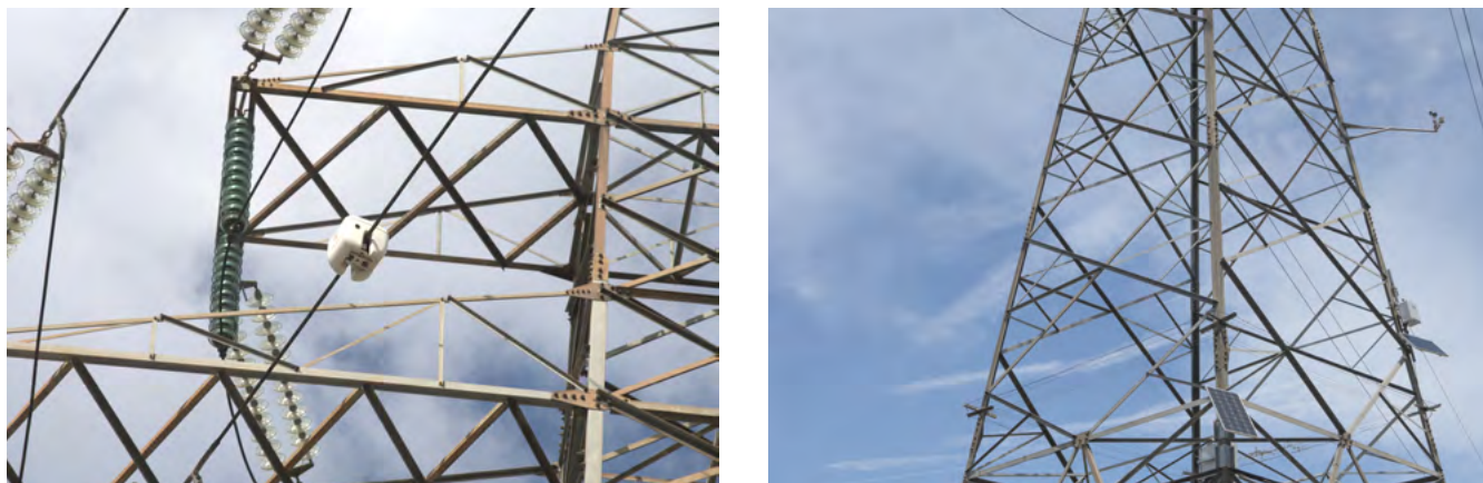
Εικόνα 27 Αισθητήρες DLR εγκατεστημένοι στη Γραμμή Μεταφοράς Θεσσαλονίκη – Εύοσμος
